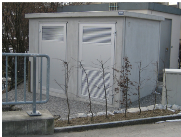
Neue Trafostation Blumenau
